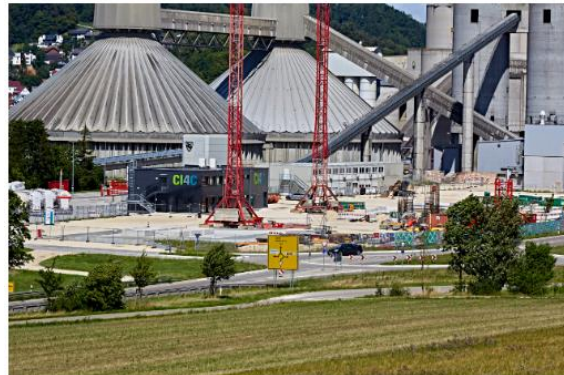
Der Bau der Versuchsanlage auf dem Gelände von Schwenk in Mergelstetten hat bereits begonnen. © Foto: Markus Brandhuber
